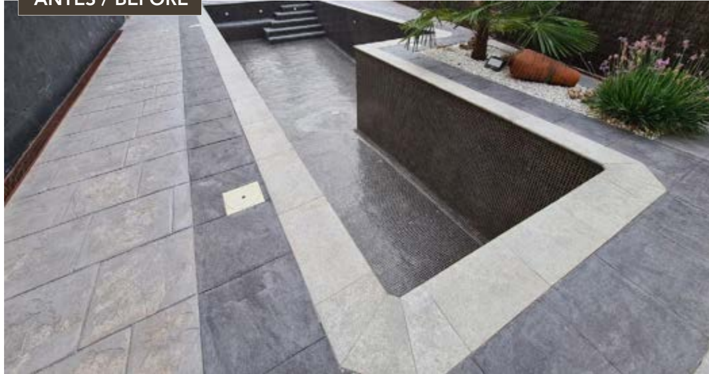
Piscina anticuada con vaso de gresite y playa de gres dañado. Old-fashioned pool with a mosaic glass pool tiles tank and damaged border.
